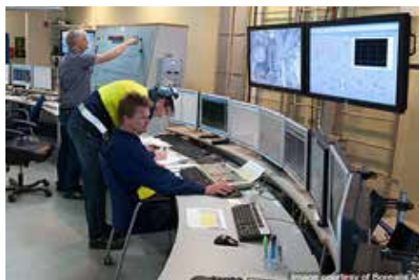
W sterowni prowadzona jest dokładna obserwacja przepływu wszystkich gazów w zakładzie.
