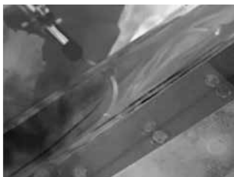
Inna nietypowa lokalizacja wycieku. Wskutek nieszczelności połączenia gaz wydostaje się z materiału izolacyjnego.
