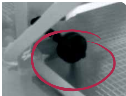
Wyciek gazu jest wyraźnie widoczny na obrazie termicznym.
