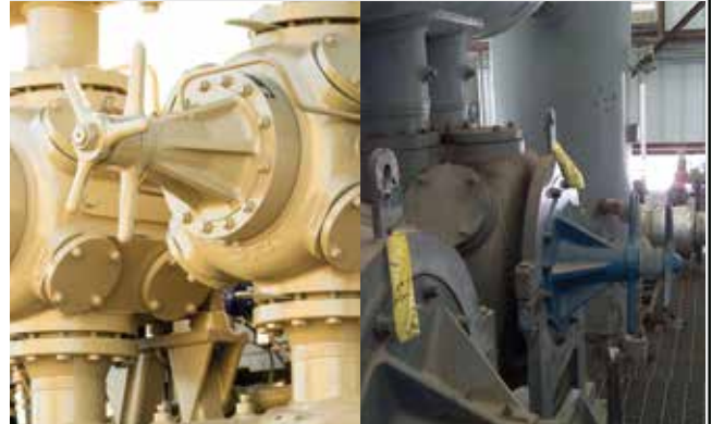
Las fugas de gas pueden ser difíciles de encontrar cuando los componentes que fallan no son visibles desde el exterior del compresor.
