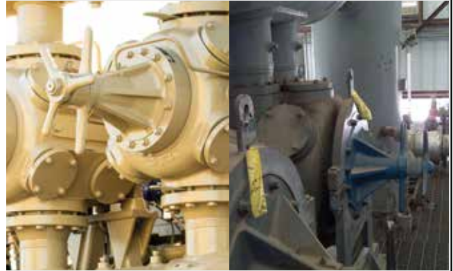
Les fuites de gaz peuvent être difficiles à détecter lorsque les composants défectueux sont invisibles de l'extérieur du compresseur.
