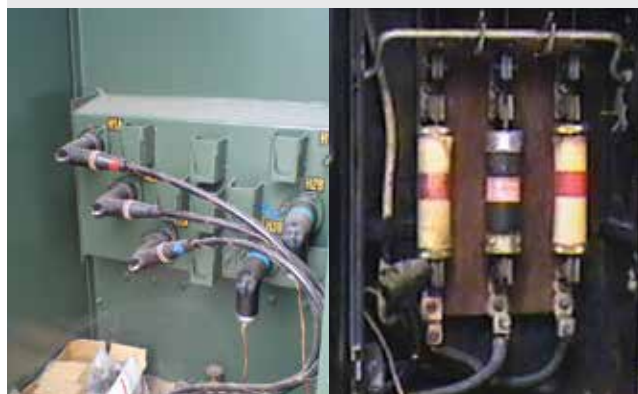
Falhas elétricas podem causar tempos de inatividade imprevistos, reparos onerosos e perda de produção.
