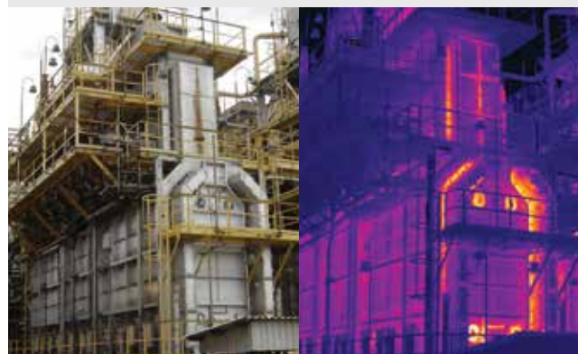
Imagens térmicas da superfície externa da estrutura da caixa de incêndio e dos dutos de combustão podem identificar áreas de superaquecimento devido a danos refratários internos.
