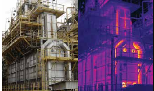
L'immagine termica della superficie esterna dell'involucro della camera di combustione e dei condotti di scarico può identificare aree surriscaldate a causa di danni al materiale refrattario interno.
