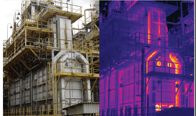
Warmtebeelden van schil van de stookruimte en afvoerkanaal kunnen locaties van oververhitting aan het licht brengen door beschadiging van de vuurvastheid aan de binnenzijde.
