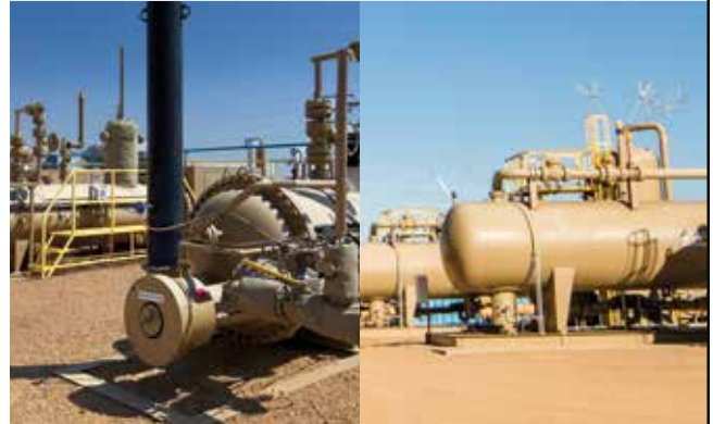
Es importante detectar de forma temprana los problemas en los separadores, antes de que fallen, porque reemplazarlos es muy caro.
