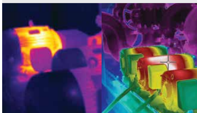
La termografia facilita l'identificazione di punti caldi su pompe e motori, indicando un surriscaldamento che può portare a un guasto.
